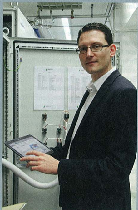
KRAFTWERK AM TABLET. Seamtec-Geschäftsführer Peter Reiter zeigt, wie eine Steuerungszentrale für ein Wasserkraftwerk heute aussieht.
